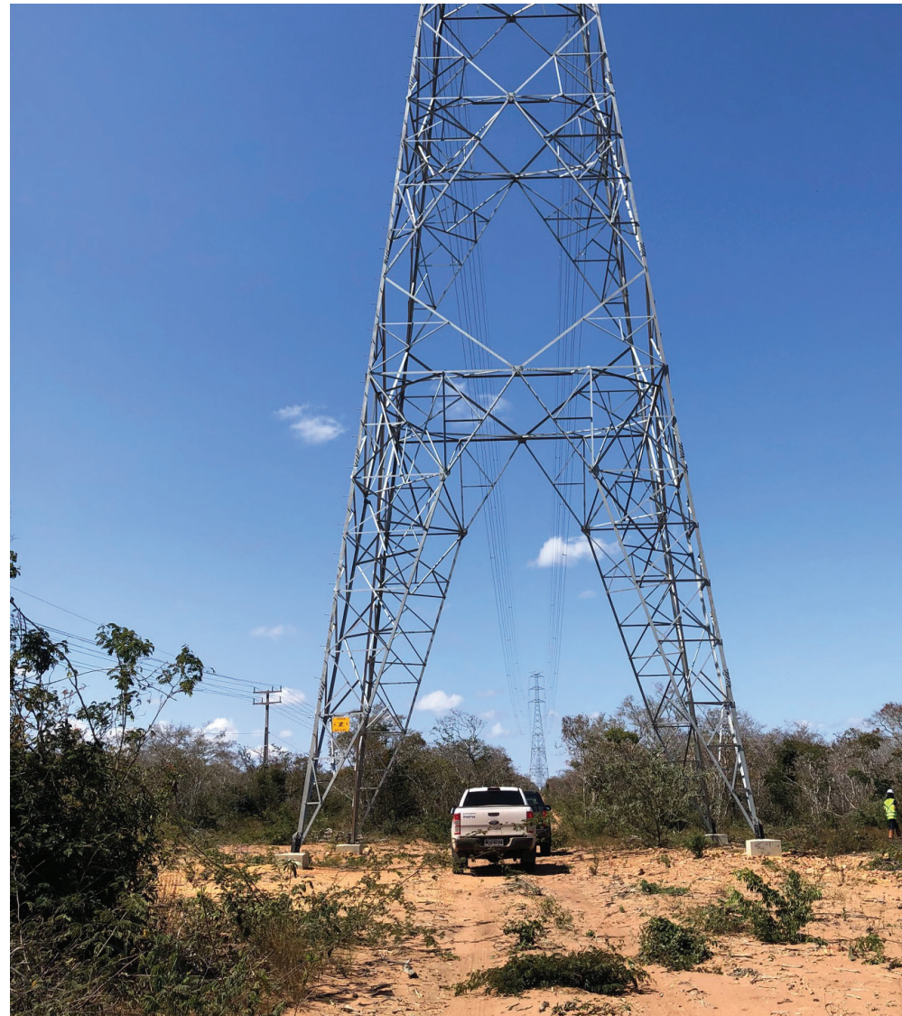
FAIXA DE SERVIÇO E PRAÇA DE TORRE NO INTERIOR DA FAIXA DE SERVIDÃO
