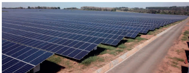
Ilustração de painéis fotovoltaicos instalados. Fonte: Acervo Grupo Cobra, 2017.
