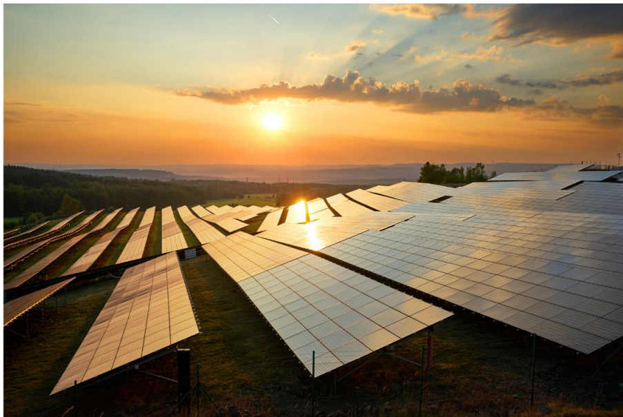
Figura 2.2: Representação de módulos instalados.
