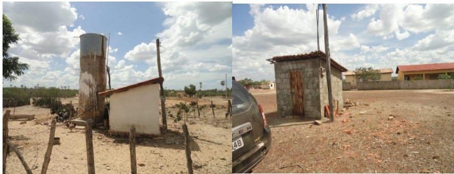
Figura 21 – Fotos dos poços de captação de água subterrânea no entorno do empreendimento
