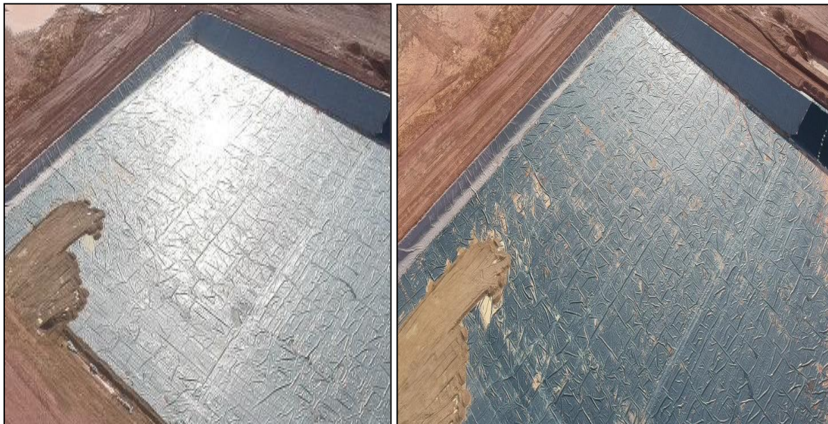
Figura 10.0: Sistema de Impermeabilização com geomembrana de PEAD.
