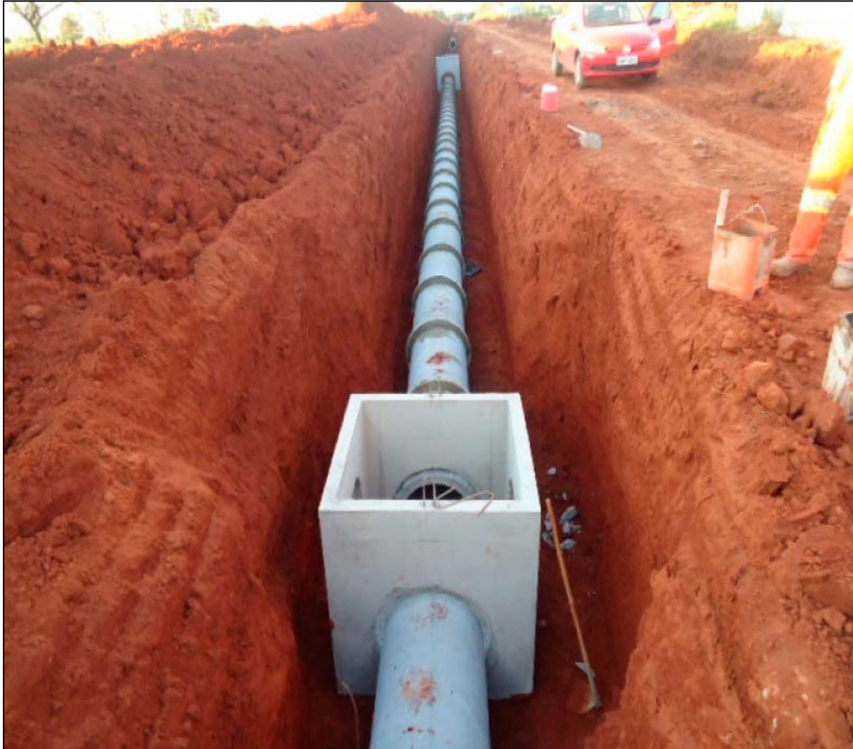
Figura 23.0 - Exemplo de Caixas de Passagem associado com Canaleta.
